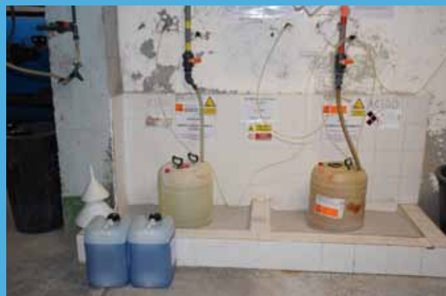
Figura 8. Los productos químicos implican la máxima seguridad en su almacenaje y uso.
