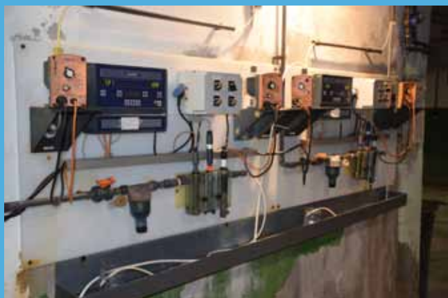
Figura 7. Equipos de dosificación.
