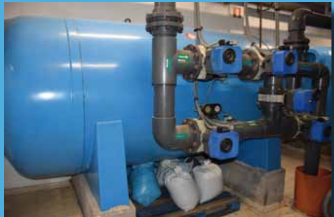
Figura 6. Equipo de filtración de la piscina grande del Complejo Deportivo La Magdalena.
