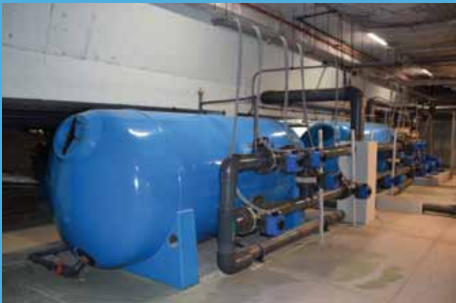
Figura 5. Equipos de filtración de la piscina grande del Complejo Deportivo Avilés.
